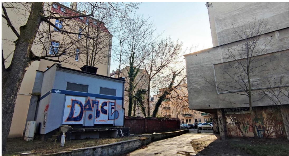
[zdjęcie – stan istniejący – widok trafostacji przed budynkiem od strony wschodniej. 04.2023 r.]
